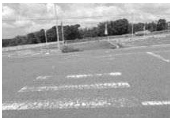
道路標示が薄くなっている横断歩道(丸山地内)
