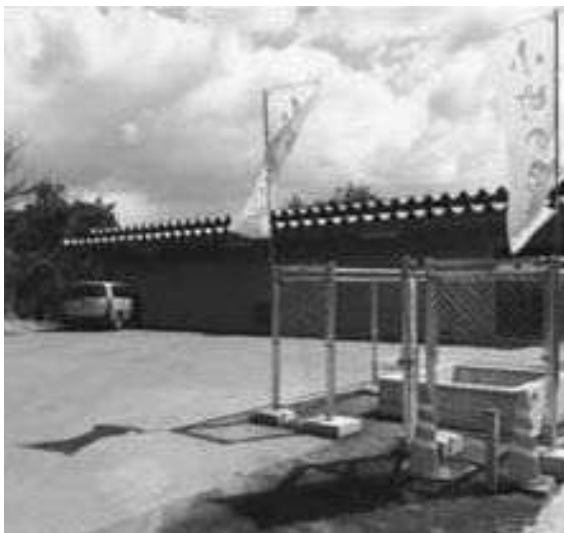
小野地区専用水道第3水源池 (小町地内) (H27年3月竣工 取水能力1,162m 3 /日以上) “小町の名水” (グリーンパーク大山ゴルフクラブ内)
