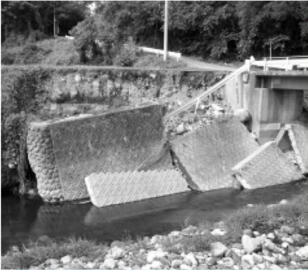
台風12号災害（久古地内）
