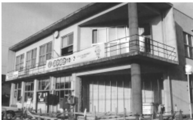
鳥取西部地震で被災した旧溝口町役場（平成12年）
