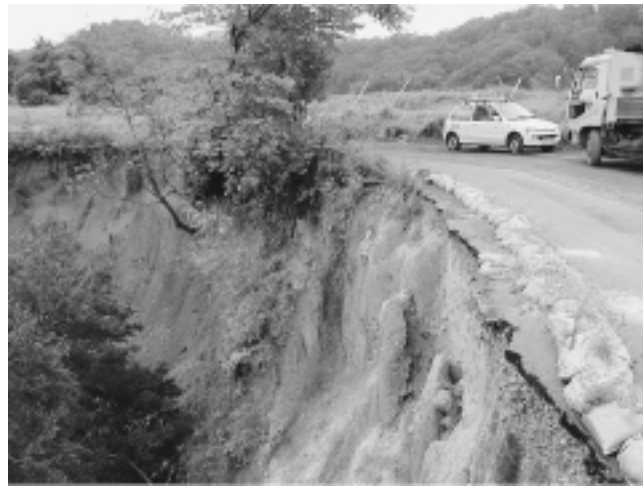
鳥取西部地震により道路路面が崩壊（大倉地内の農道）
