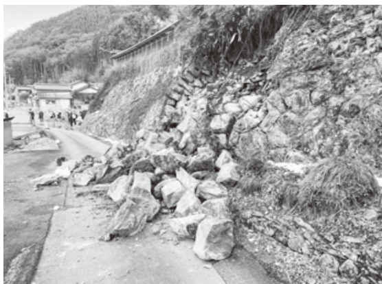
▲令和8年1月の地震被害の様子
