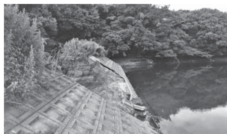
今回の豪雨で発生したため池の崩壊（県中部）
